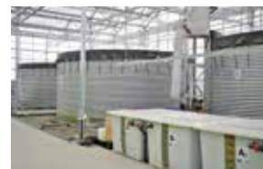
原液タンク(手前) 用水タンク(奥)
