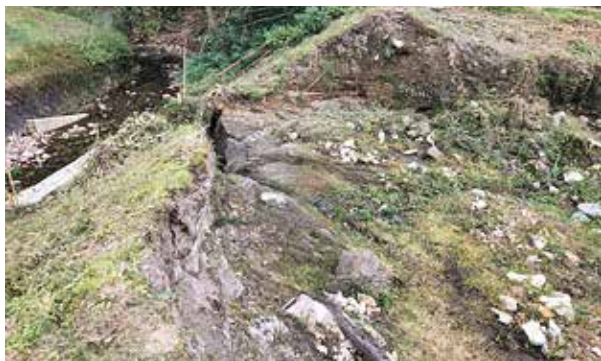
農地の被災状況1
