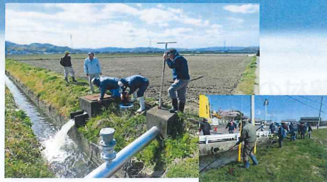
ポンプ送水準備作業 (田野芝生土地改良区)
