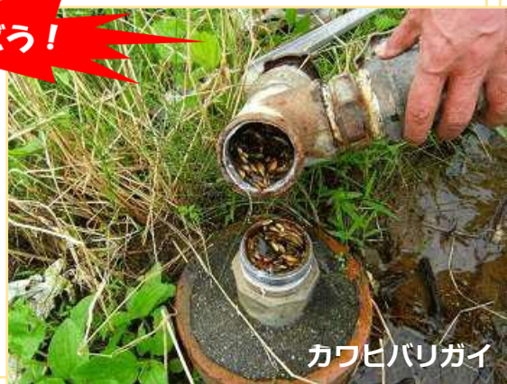
外来貝類による給水栓の目詰まり
