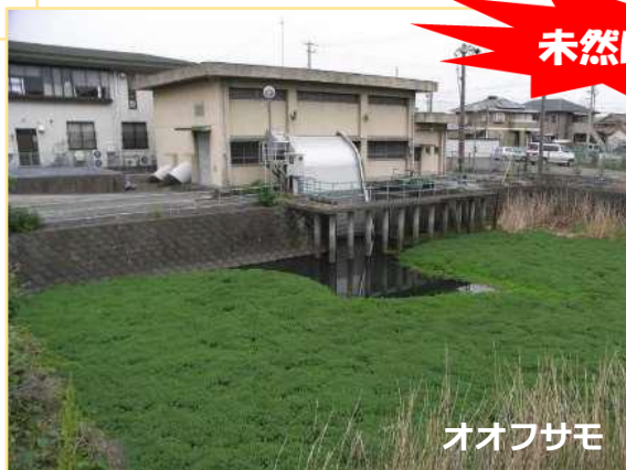
ポンプ場での外来植物の大発生
