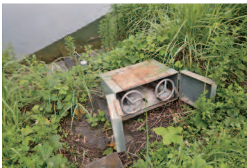
取水施設の老朽化の状況
