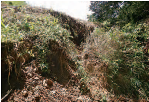
堤体を越流し浸食している状況
