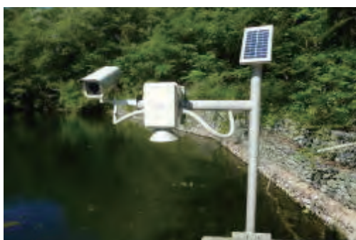
遠隔監視機器の確認
