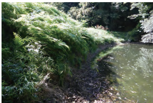
堤体が波浪により浸食している状況
