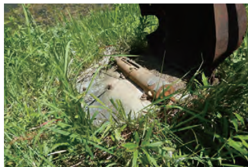
取水施設の老朽化の状況
